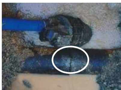
【地中で折れた水道管】
