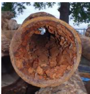
【錆による水道管の腐食】
