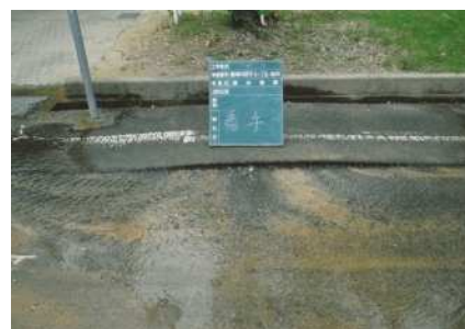
【水道管の破損による漏水】
