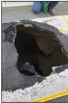
【下水道管きょに起因した道路陥没】
